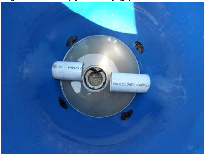
Regard de collecte (après nettoyage)
